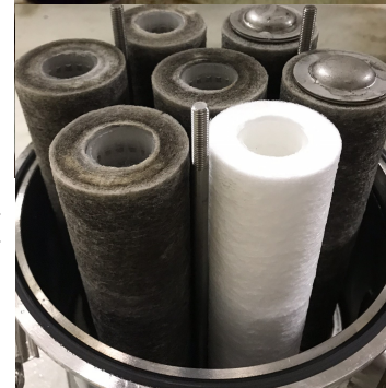
Bauers filterbehållare med de smutsiga filterpatronerna och skillnaden mot ett nytt filter.
