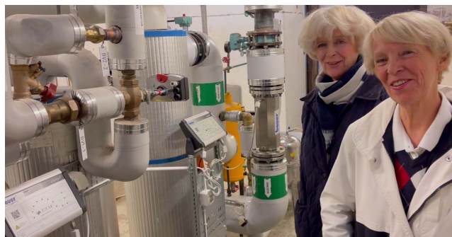
Ordförande Siv Sondell och vice ordförande Lilian Baaz bredvid Bauer PipeJet installationerna
